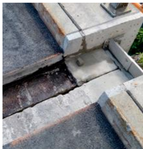
Desolates Tragwerk im Lagerbereich
