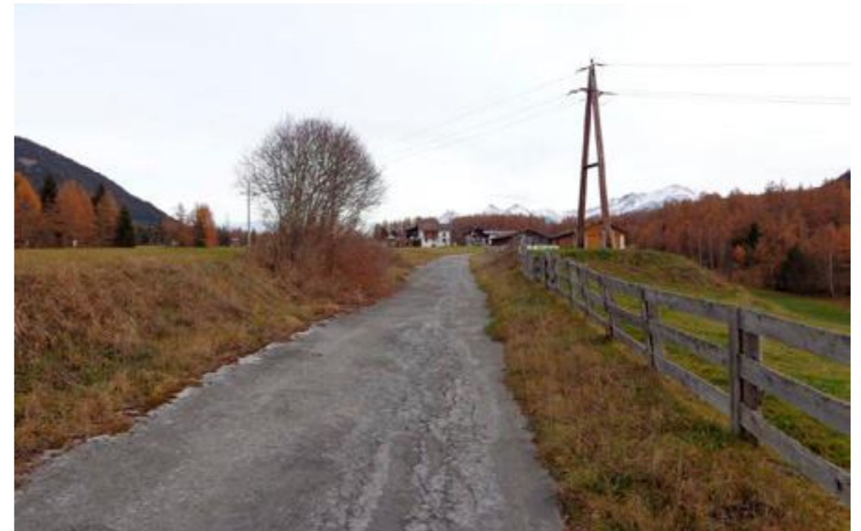
Baulosende Holzleiten vor dem Ausbau
